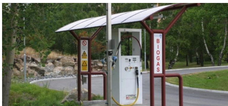
photo 2 : station à biogaz
